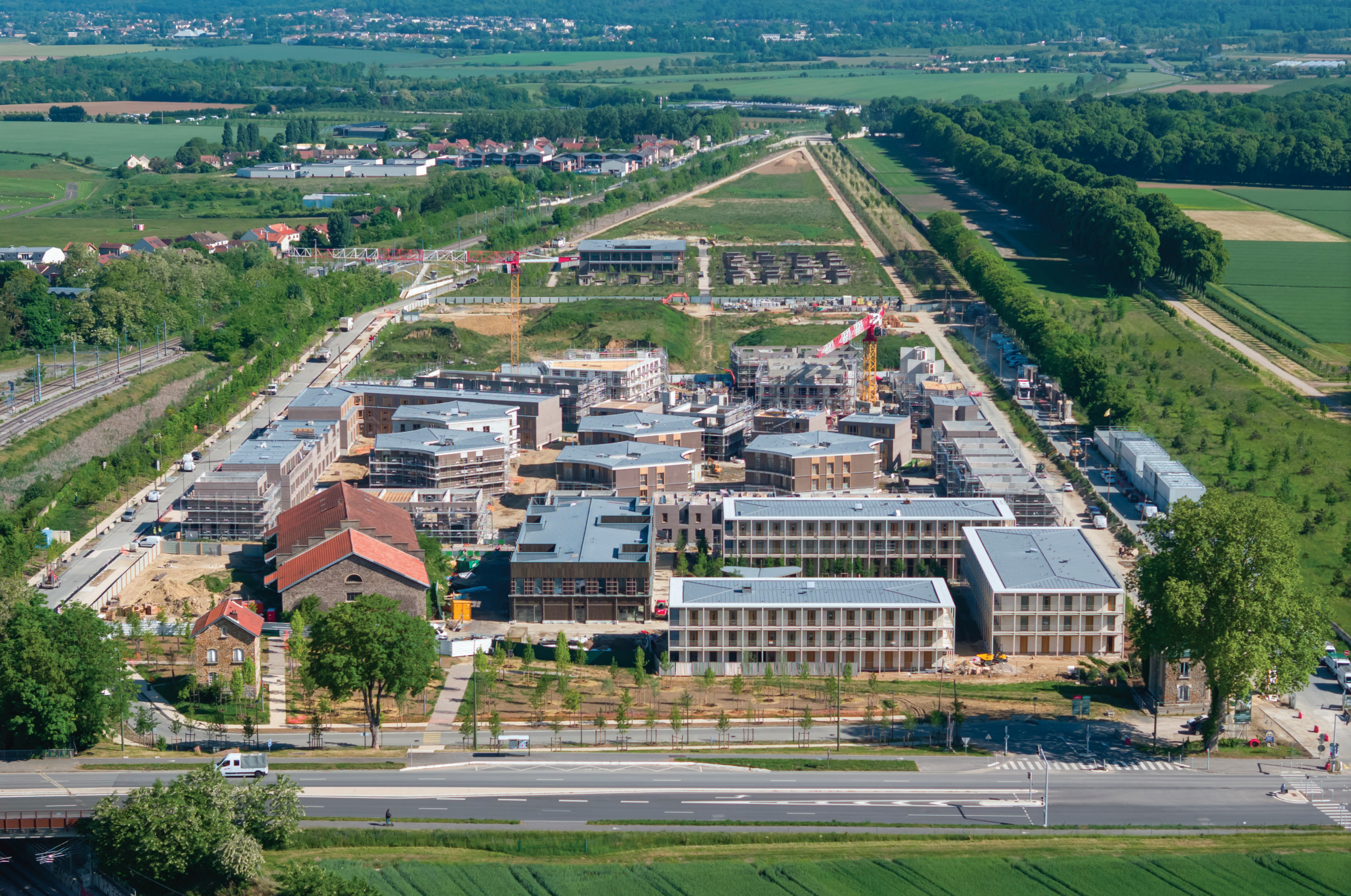
Quartier de Gally | avancement du chantier en mars 2025 - Source : Ville de Versailles
